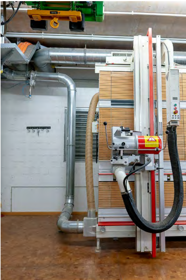
Abb. 3.1.2-07 Absauganlage an einer vertikalen Plattensäge
